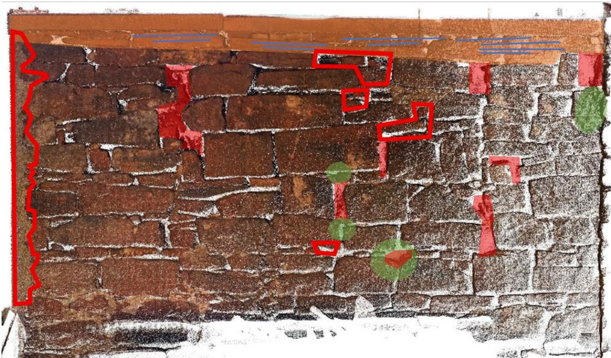
Bild: Beispiel Schadenskartierung einer Grenzmauer
