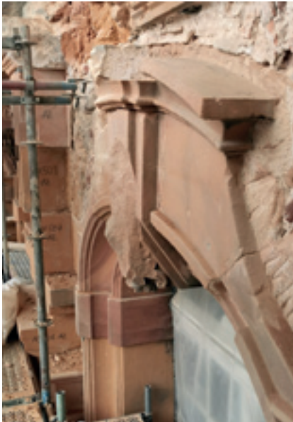
Schwere Kriegsschäden am Mittelrisalit vor der Restaurierung Fotos: Firma Glöckner
